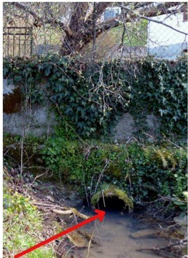
Bouche d'égout avec sortie côté Salat
